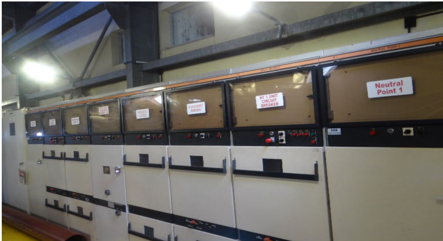
Existing 2.2kV switchgear in Trafalgar
